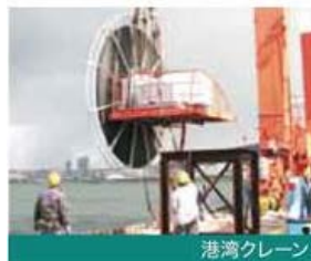
港湾クレーン
